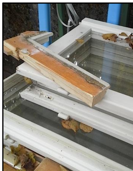
Abbildung 6: Fensterrahmen mit Resten von Anschlagkitt (Bafob GmbH, 2018)
