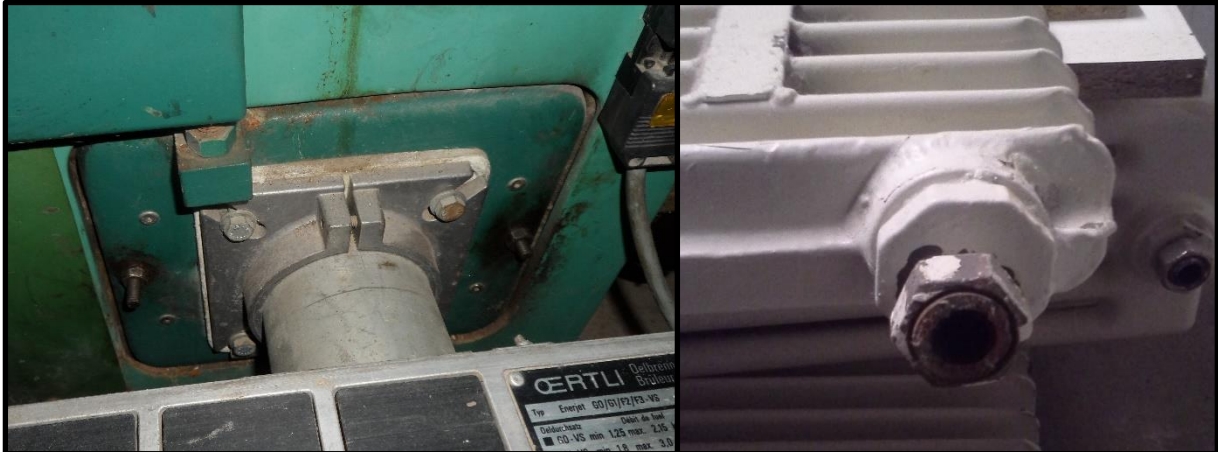
Abbildung 3: Asbesthaltige Brandschutzplatte zwischen Heizkessel und Brenner. Asbesthaltige It-Dichtung an der Radiatorverbindung. (Bafob GmbH, 2018)
